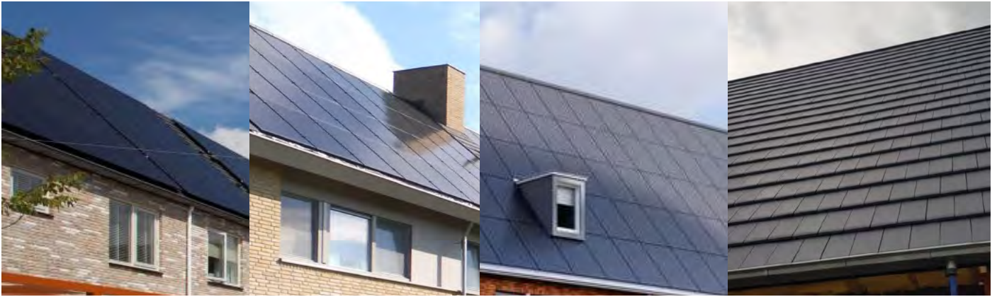
Zwart pannendak met platte moderne dakpan, zonnepanelen vallen weg in het dakvlak.
