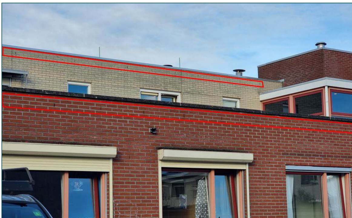
Figuur 3.1 Weergaven van de aanwezige open stootvoegen op elke bouwlaag (rood omljnd) welke direct toegang bieden tot de open luchtspouw.
