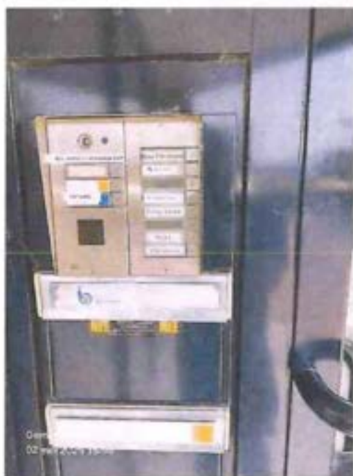
Foto 2 Deurbel overzicht wijziging t.o.v. eerder controle d.d. 25 april 2025 sticker is verwijderd bij de deurbel, maar niet op de brievenbus.
